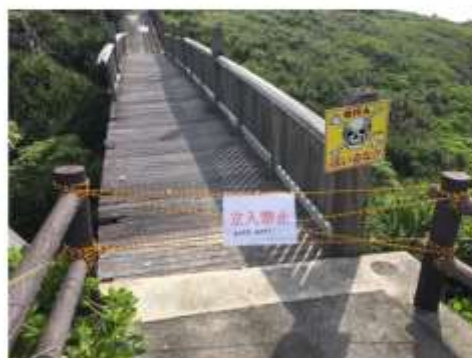
白鳥崎の木道橋 手すりや破損しており、歩道部分も腐食していて、現在通行止め。解体して、転落防止柵を設置予定
