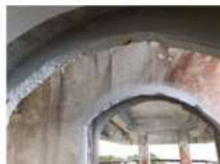
内側が崩れ落ちていて危険。
