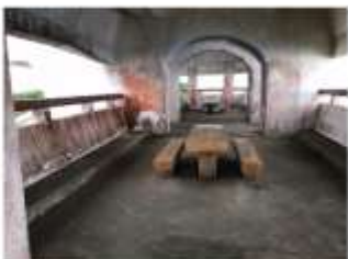
ベンチも座るには汚れすぎている。
