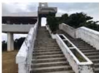
手すりのベンキが剥がれ落ちている。
