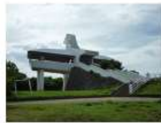
牧山展望台。施設が老朽化しており、修繕が必要。
