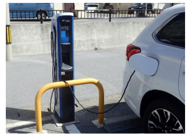
EV充電スポット
