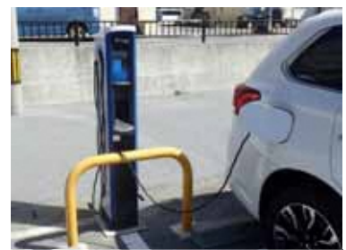
EV 充電スポット
