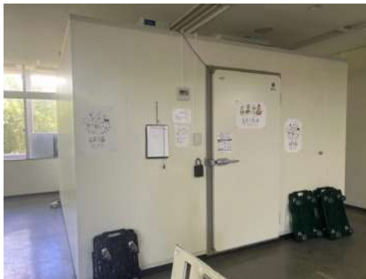
庁舎内冷蔵庫外観
