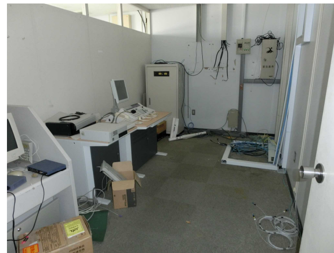
3階防災関係機器室
