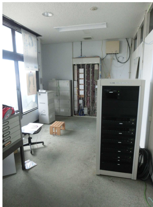
3階防災関係機器室
